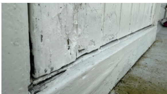
Råteskader balkongdør loft.
