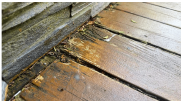
Råteskader i terrassebord mot mur.
