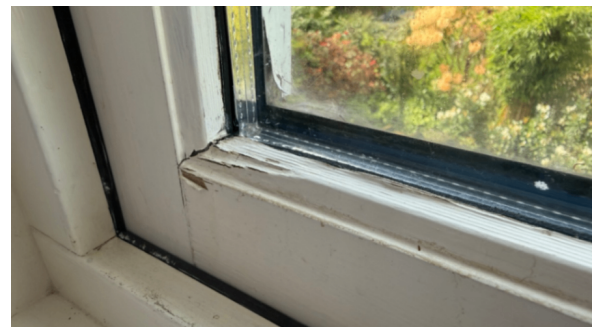
Fuktskader på innvendig karm.
