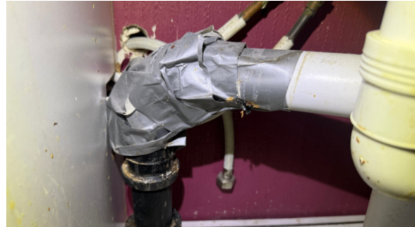
Ufagmessig utførelse av avløp.
