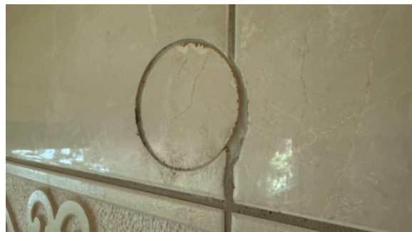
Hull i fliser som er lappet igjen.
