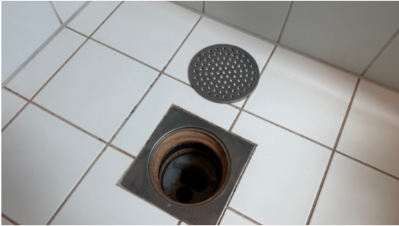
Sluk i dusjsonen.
