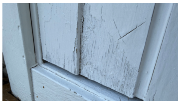
Slitasje balkongdør stue.
