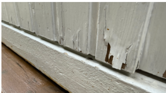
Slitasje balkongdør vaskerom.
