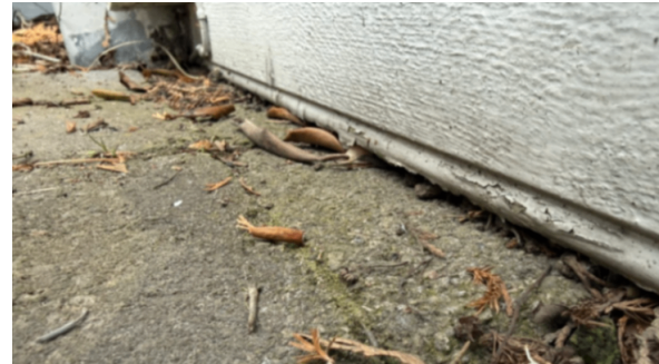
Kledningen ligger stedvis for nærme bakken.
