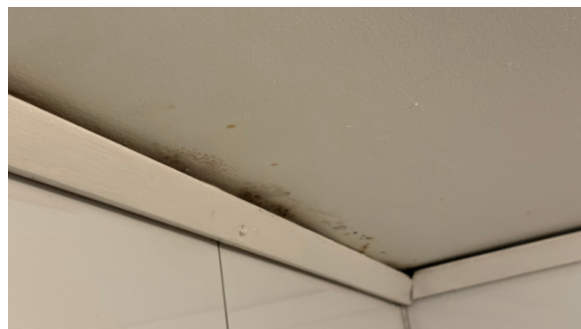
Svertesopp i taket over dusjsone.
