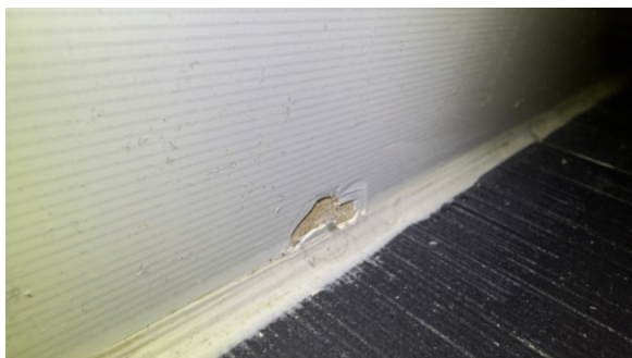
Skade på flis.
