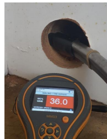
Kontroll i lukkede konstruksjoner - Fuktmåling i utlekket vegg mot terreng, utført i bod ved soverom.
