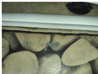
Overflater gulv - Utettheter i beleggveis i dusjsonen
