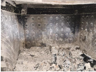
Ildsteder - Sprikk i bakplate
