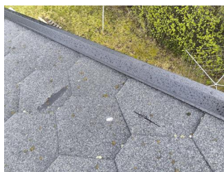
Tekking (med tilhørende beslag) - Skade i taktekking
