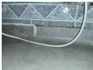
Overflater gulv - Skade i belegg og overgang mot veggplate
