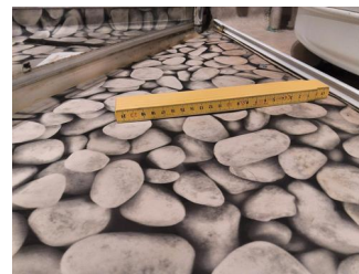
Overflater gulv - Hevelse i plate grunnet svelling
