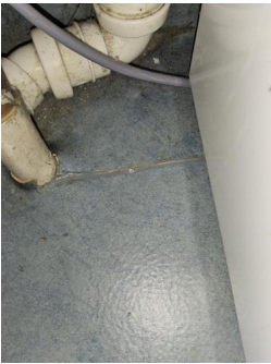
Vannnett sjikt / membran i gulv og vegger - Sprekker i sveiseskjøter gulvbelegg.
