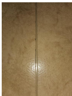
Vannnett sjikt / membran i gulv og vegger - Sprekker i sveiseskjøt på gulv.
