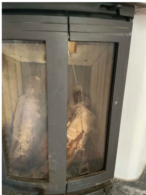
Ildsted med glasskader på 2 felt
