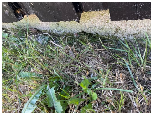
Ingen synlige fuktsikringer ved utvendige grunnmurer på opprinnelig del
