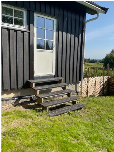
Terrengtrapper uten rekkverksikring
