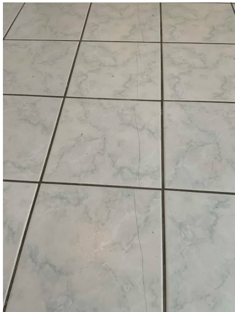
Gulvfliser med gjennomgående sprekker
