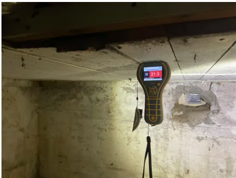
Verdier over faregrense for utvikling av sopp og råteskade
