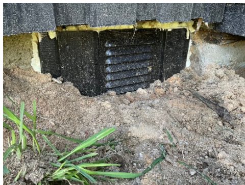
Ventil ligger nært terreng
