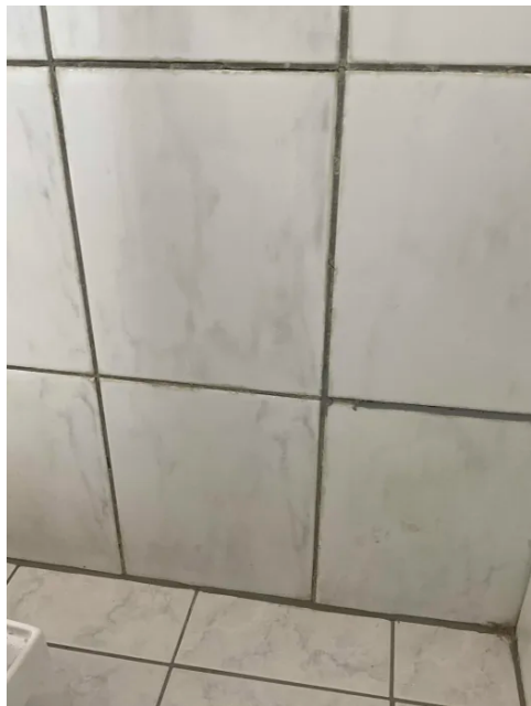
Veggfliser med mangelfull heft/boom
