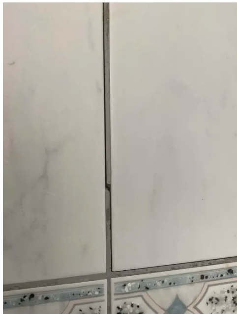
Støpte fuger med oppsprekking og generell slitasje
