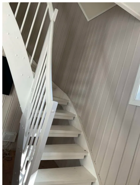
Trapp med manglende håndløper
