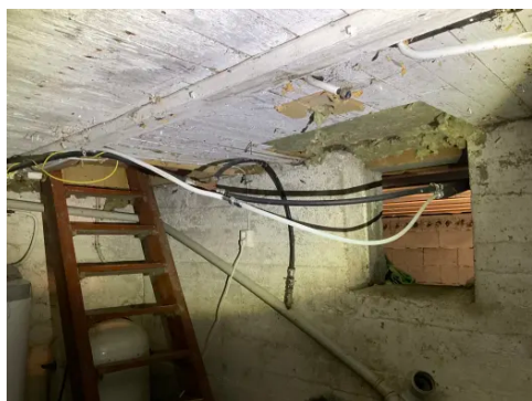
Installasjoner med mangelfull innfestning i kjeller
