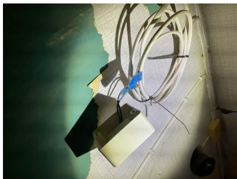
Det registreres mangelfull innfestning på det elektriske utstyret
