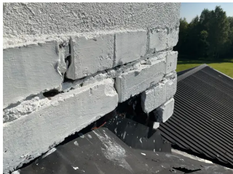
Slitte fuger over tak
