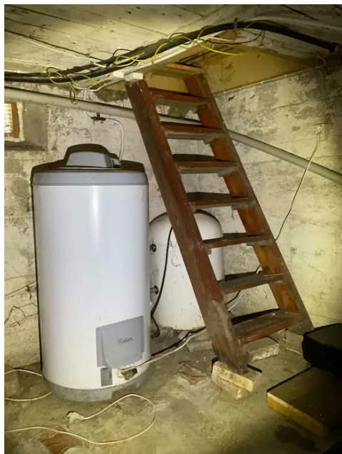
Bereder plassert i kjeller
