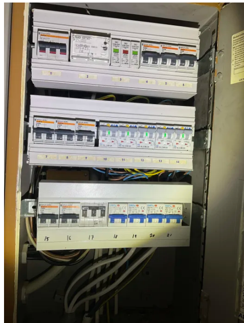
Sikringsskap plassert i innvendig bod 1.etasje
