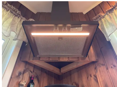
Komfyrvakt er montert
