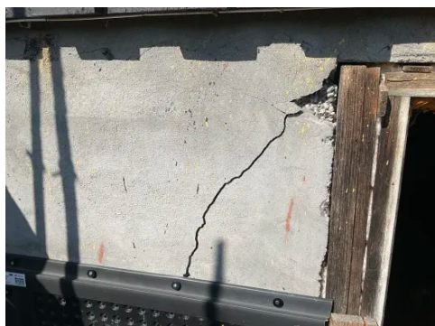
Sprekkdannelse på grunnmurer
