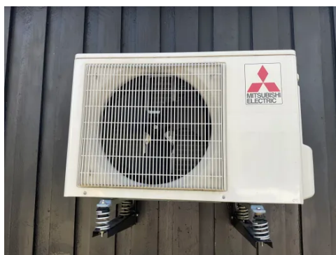
Luft/luft varmepumpe påvist fra 2021
