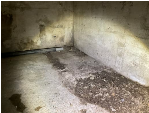
Tradisjonelle tegn etter fuktproblematikk ved rom under terreng
