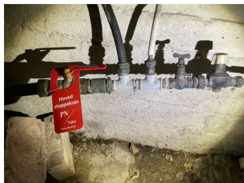
Hovedstoppekran med synlig merking
