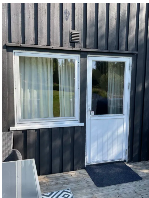
Terrassedør med vedlikeholdsbehov
