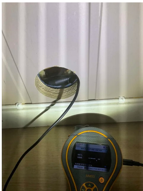
Fuktsøk med hulltaking, ingen unormale verdier
