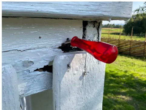
Rekkverk med råteskader
