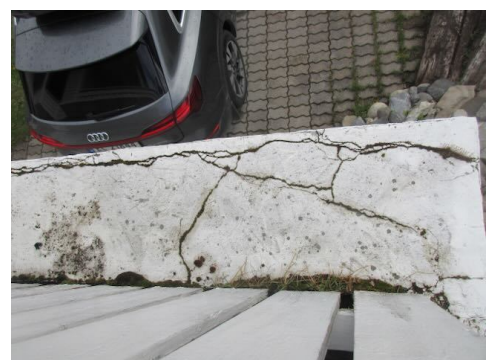
Sprekker utvendig på betongdekke.
