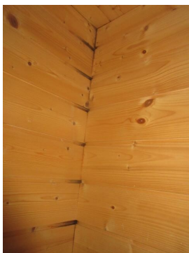
Kondensmerker på vegger mot yttervegger.
