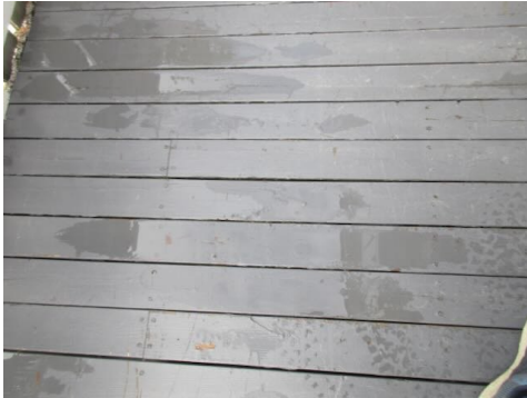
Råteskade på terrassegulv/tilfarere utenfor stue.
