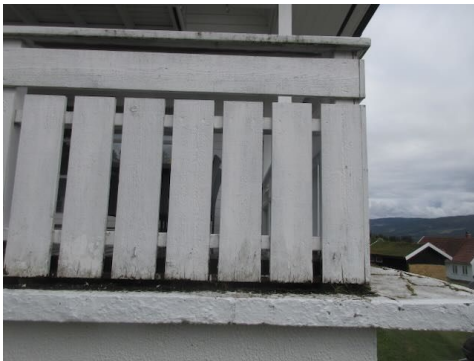
Råteskade på terrasserekkerkverk utenfor stue og kjøkken.
