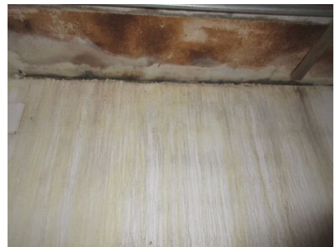
Lekkasje fra betongdekke.
