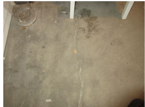
Sprekker i betonggulv.
