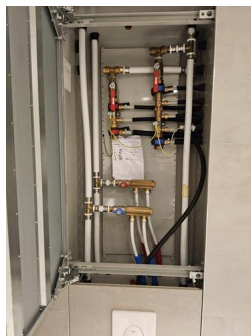
Fordelerskap og fordelerstammer - Fordelerskap, rør i rør.
