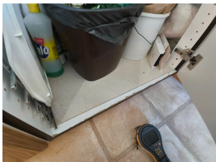
Kjøkkeninnredning bærer preg av slitasje.
