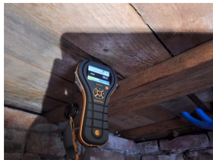
Det ble utført fuktmåling fra underliggende kjeller mot etasjeskille under våtrom. Målingene viste noe forhøyede verdier i 'treverk ved slukområdet. Det ble ikke registrert synlige tegn til aktive lekkasjer eller skader ved befaringstidspunktet.
