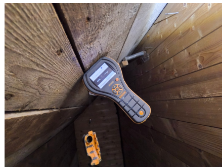
Ved enkel fuktmåling ble det registrert tørre verdier. Misfargingen ble vurdert som tørr på befaringdagen.
