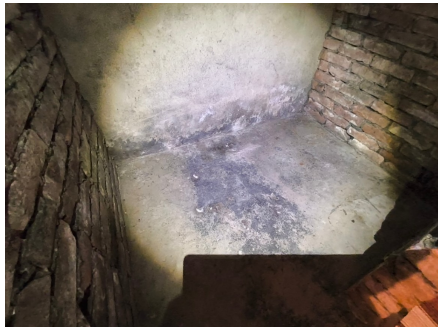
Synlig misfarging på gulv vegg.
