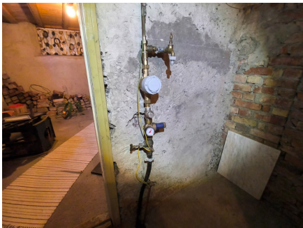
Hovedstoppekran etablert i kjeller.
