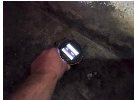
Det ble registrert forhøyede fuktverdier og synlige fuktutslag på grunnmur/kjellervegg.
