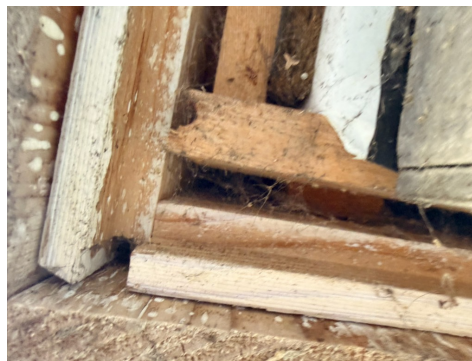
Manglende lufting i veggkonstruksjonen.
