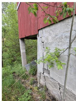
Fundament, grunnmur og gulv mot grunn - Eksempel på sprekker i grunnmur og skjevhet i søylefundament.
