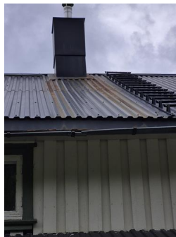
Tekking (med tilhørende beslag) - Eksempel på slitasje på taktekking.
