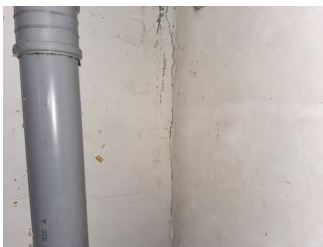
Overflate vegg - Eksempel på sprekker i vegg.
