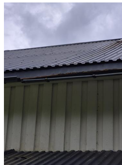
Takrenner og utvendige nedløp - Eksempel på skade i takrenne.
