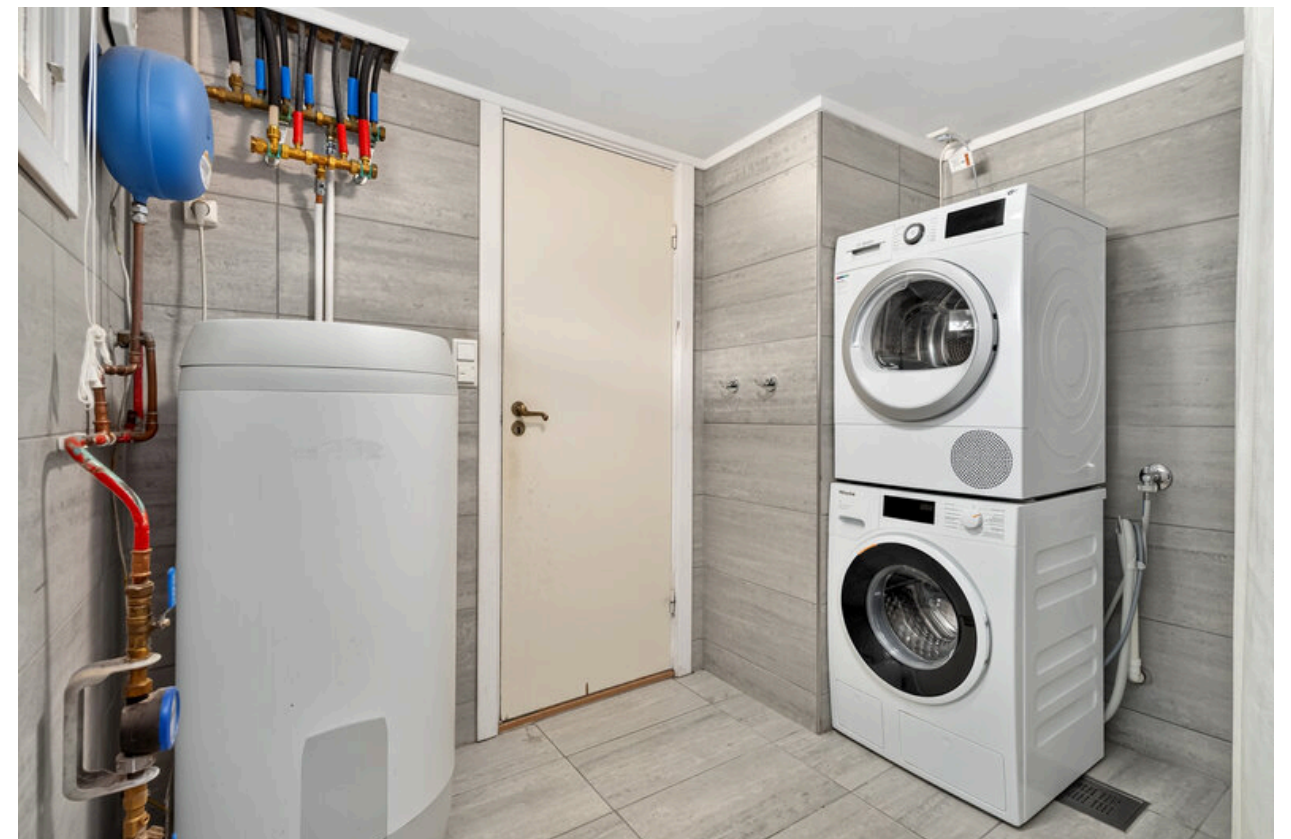
Varmtvannsbereder og opplegg for vaskemaskin.
