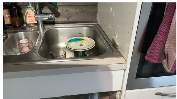
Skader og svelle-skader flere steder.
