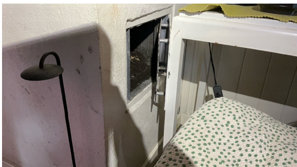
Kort avstand mellom sotluke og brennbart materiale.
