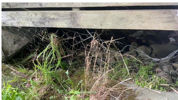
Ikke tilkomst under boligen grunnet netting.
