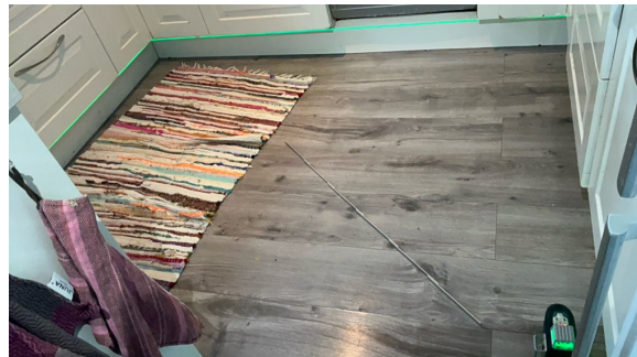
Helningsavvik på ca. 25 mm innen 2 meter i kjøkkenområdet.
