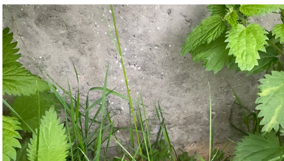
Sprekker/riss i grunnmur.
