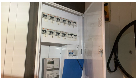
Sikringsskap i entrè.
