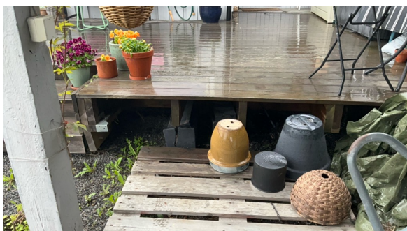
Manglende rekkverk på terrasse.
