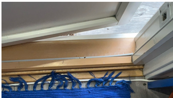
Slitt pakning på terrassedør.
