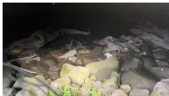
Fuktig grunn under boligen. Jeg anbefaler ytterligere undersøkelser av kryprom under boligen for å kartlegge tilstanden for eventuelle utbedringer.
