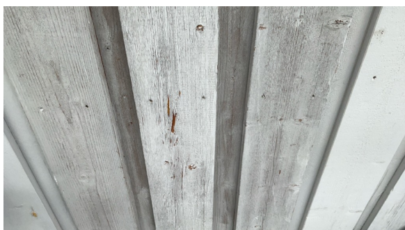
Deler av kledning bærer preg av slitasje.
