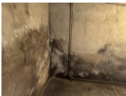
Fuktskjolder i grunnmur
