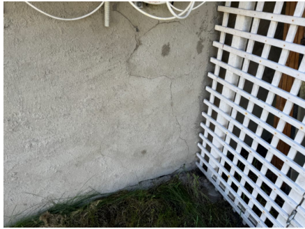
Sprekker i overflater av grunnmur
