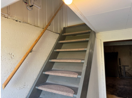
Trapp uten rekkverk
