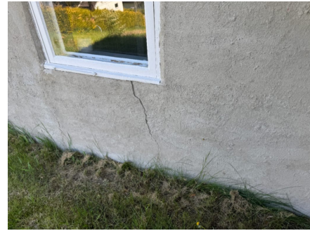
Sprekker i overflater av grunnmur
