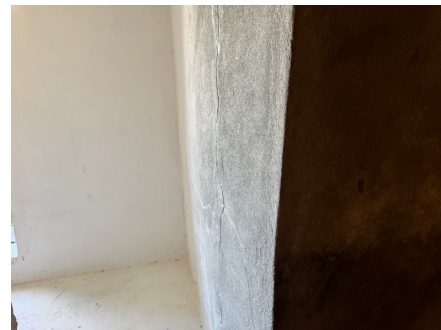
Skjevheter i grunnmur
