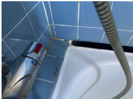
Sprekker i fliser og fuger
