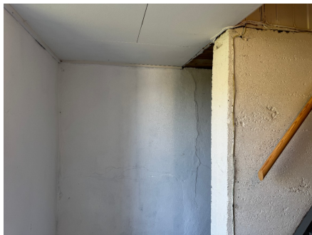
Sprekker i overflater av grunnmur
