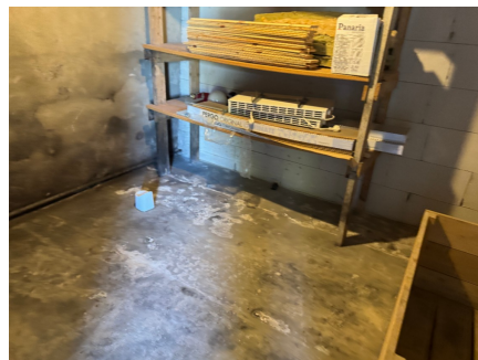
Saltutslag og fuktskjolder i grunnmur og kjellergulv
