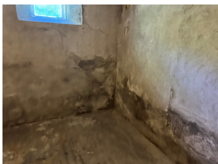
Saltutslag og fuktskjolder i grunnmur og kjellergulv
