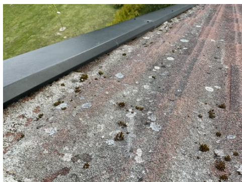
Noe påbegynt mosevekst
