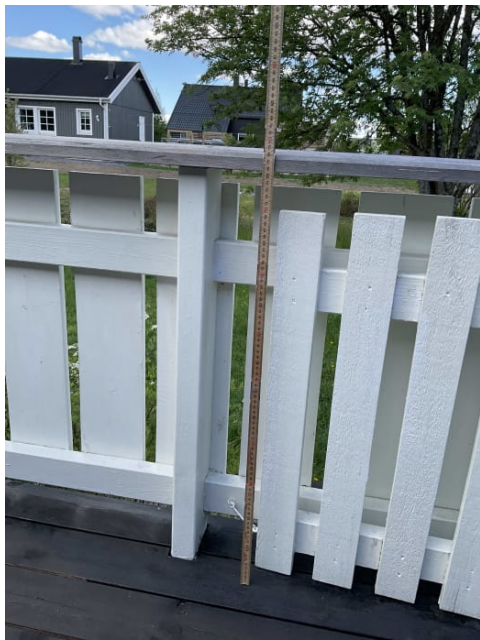
Lave rekkverkshøyder ved terrasse
