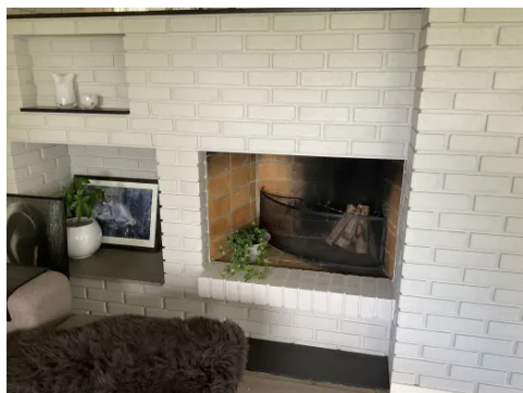
Ildsted med åpen peis i murt omramming
