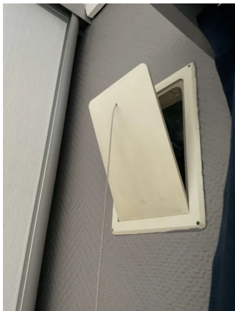
Bolig med naturlig ventilasjon
