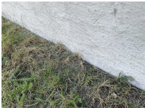
Ingen synlige utvendige fuktsikringer
