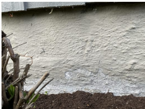
Påvist enkelte riss og lokal slitasje
