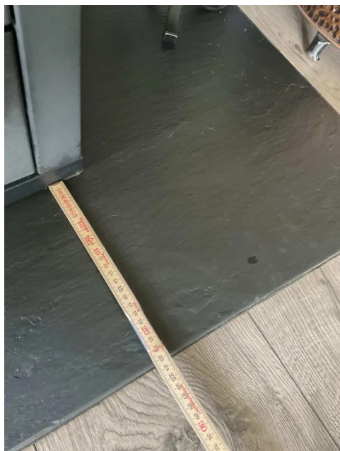
Kort gnistsikring mot gulv foran vedovn
