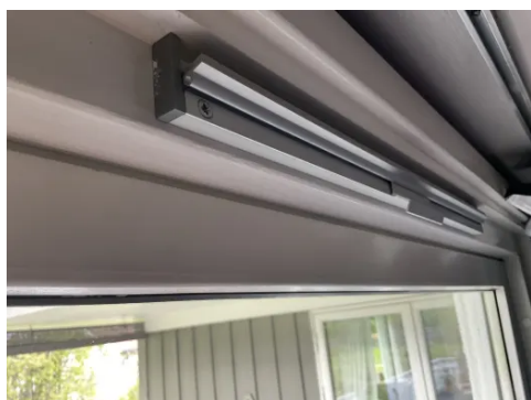
Luftespalter i øvre del av karm
