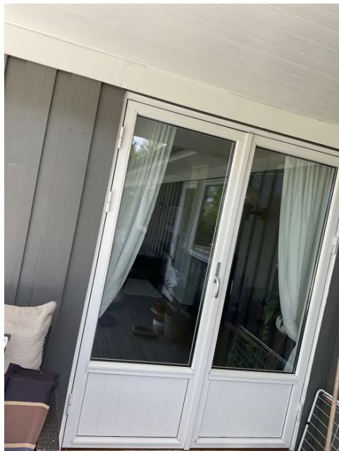
Terrassedør påvist fra 2010
