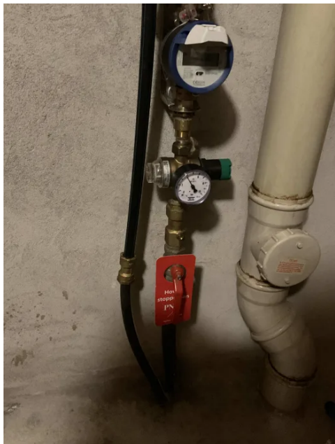
Hovedstoppekrane med synlig merking
