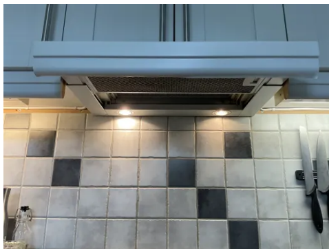
Mekanisk avtrekk over koketopp
