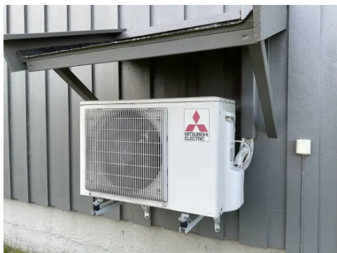
Luft/luft varmepumpe påvist fra 2008
