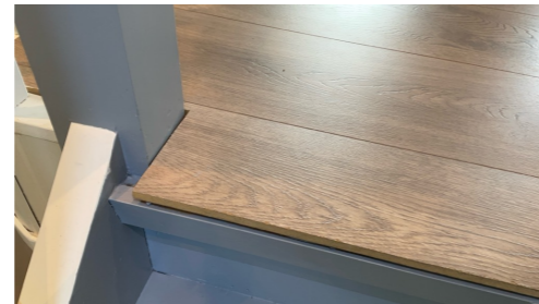
Stedvis gjenstående arbeid
