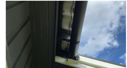
Takrenne på klosser
