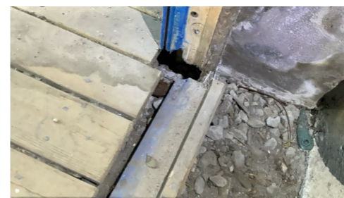
Skade dør, overgang mellom delene
