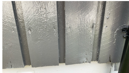
Gavl vest, råte i bordkledning
