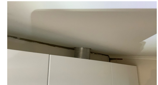
Gjenstående foring mot tak
