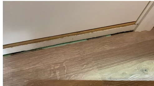
Stedvis gjenstående arbeid
