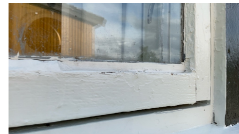
Vaskerom hovedetasje, tegn til fukt/råte i kobling, utvendig med løsna kitt, Glippe mellom trebord og vindu
