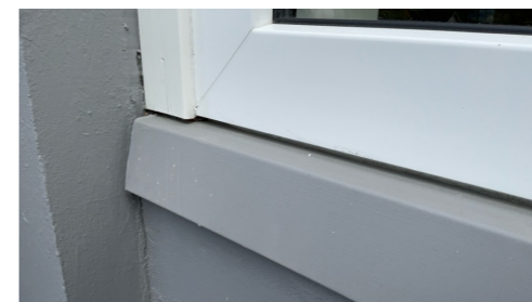
Manglende fall på beslag, listverk i glattkant
