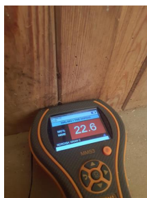
Overflate vegg - Fuktmåling med pigg i området med spor etter treskadeinsekter, bilde tatt i minste bod.
