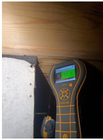
Synlige overflater (taktro, vegger, gulv, o.l) - Fuktmåling med pigg på fuktmerke ved gjennomføring over bad.
