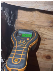
Synlige overflater (taktro, vegger, gulv, o.l) - Fuktmåling med pigg på fuktmerke ved gjennomføring pipe.
