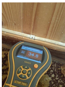
Overflate vegg - Fuktmåling med pigg på fuktmerke, bilde tatt på soverom.
