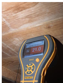
Stikktaking i treverk, fukt og fuktmålinger - Fuktmåling med pigg i overliggende etasjeskille.
