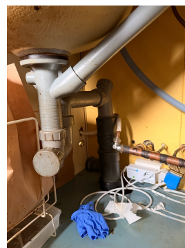
Synlige avløpsrør er utført i plast.
