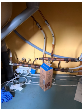
Synlige vannrør, og vannfordeling i benkeskap på kjøkken.
