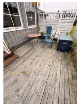
Det er i dette området fundamenteringen har sviktet.
