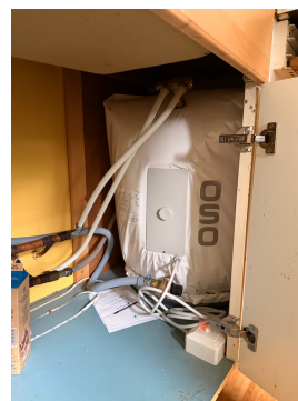
Benkebereder i skap på kjøkken.
