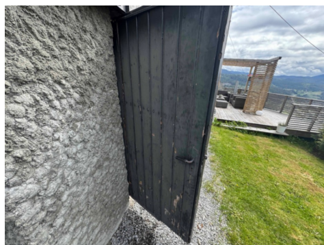
Kjellerdører med råte
