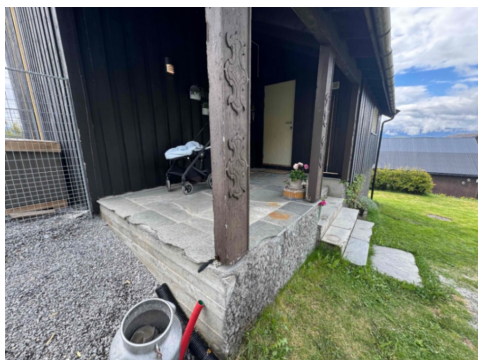
Skader på skifer og råte i søyle
