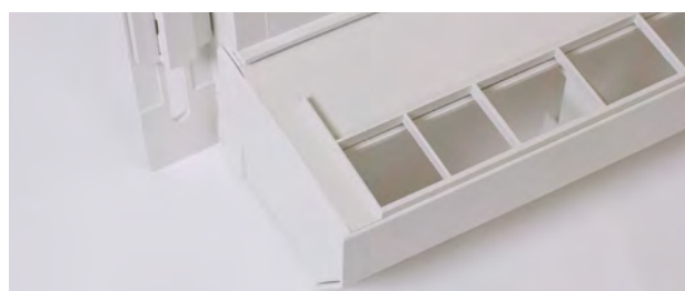
Regleringssjeld for tilluft er åpen.
