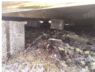
Konstruksjon og fundamenter - Skjevheter i fundamenter
