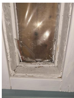
Vinduer, dører og porter - Sprukket vindu
