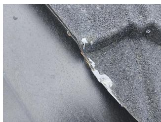
Tekking (med tilhørende beslag) - Området med overflaterust
