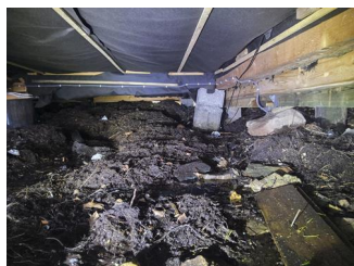
Grunnmur og fundament - Skjevheter i søyle/fundament
