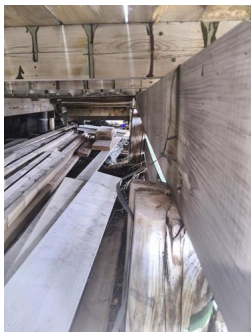
Konstruksjon og fundamenter - Skjevheter i søyler
