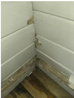
Innvendige forhold - Fuktkmerker og skader i overflatebehandling
