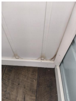
Innendige forhold - Fuktmerker på vegg
