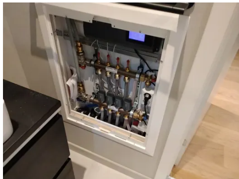
Skap for vannbåren gulvvarme.
