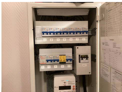
Bilde av sikringskap
