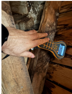
Tørre verdier ved måling der det er fuktskjolder i takkonstruksjon
