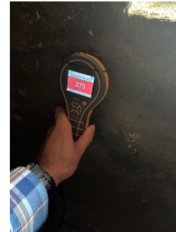
Noe utslag på fuktindikator på grunnmur
