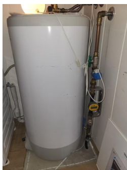
Varmtvannsbereder - Varmtvannsbereder og stoppekran
