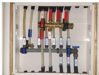
Fordelerskap og fordelerstammer - Fordelerskap for rør-i-rør system
