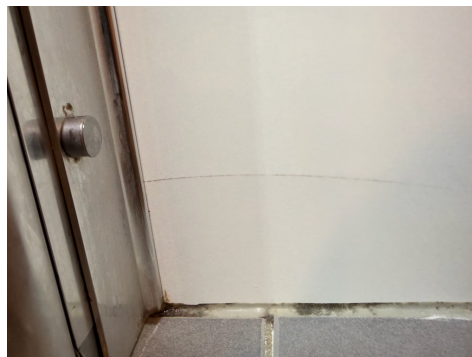
Sprekk i flis i dusjhjørnet.
