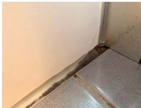
Sprekk i flis i dusjhjørnet.
