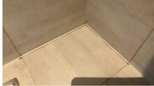
Mykfug i dusjsone har løsnet
