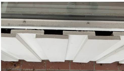
Det er påvist avvik rundt innsettsdetaljer.
