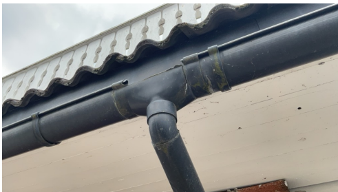
Sprekk i takrenne
