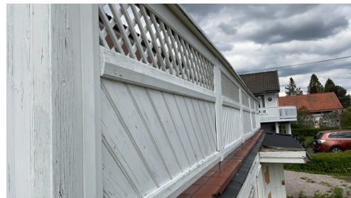
Det er etterslep på vedlikehold
