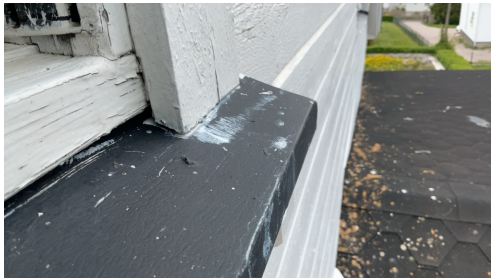
Vindusomramming står i kontakt med underbeslaget.
