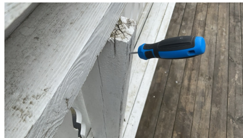
Råte i rekkverk
