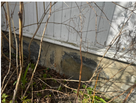
Sprekker i puss mellom steiner
