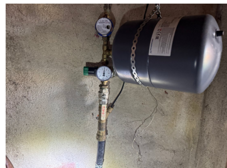
Stoppekran i kjeller
