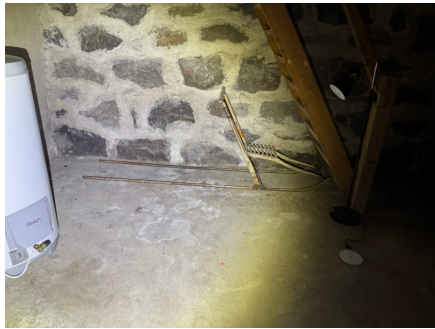
Saltutslag på kjellergulv
