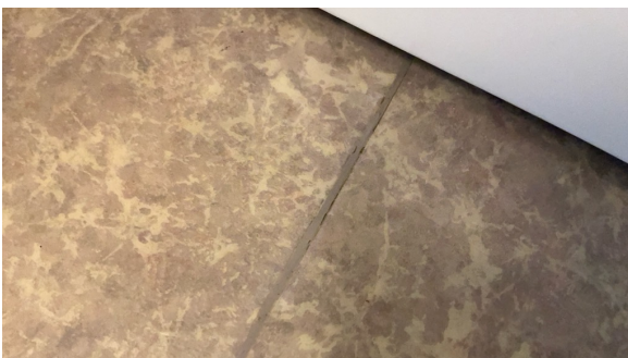
Sprekk i skjøt på gulvbelegg
