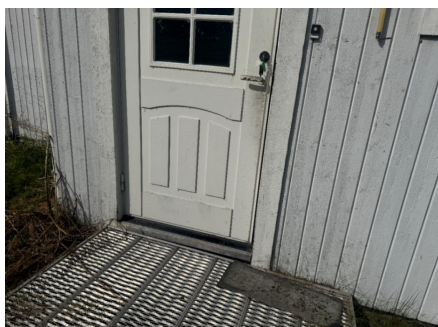
Noe slitte overflater
