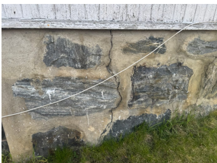
Sprekker i overflater
