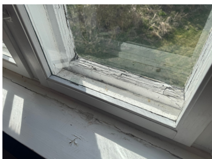
Fuktskader i vinduer
