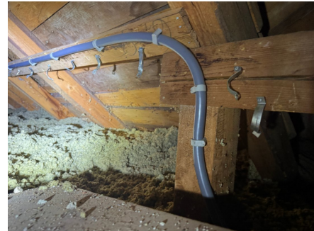
Begrenset lufting i nedre del av takkonstruksjon
