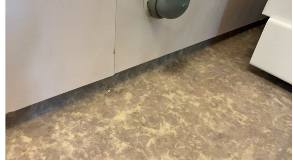
Ikke montert sokkellist på baderomsplater
