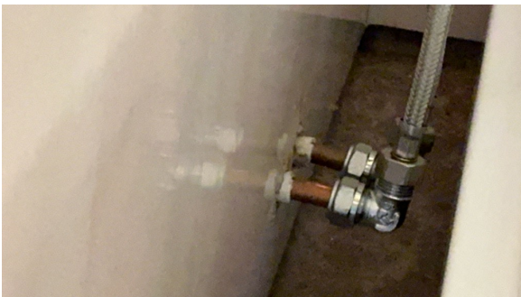
Utett rundt rørgjennomføring
