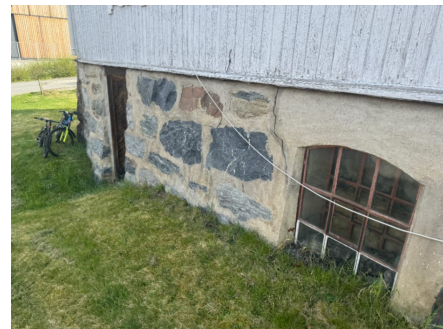
Sprekker i overflater
