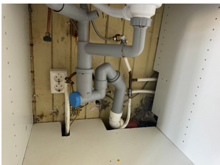
Kobber vannrør i benkeskap på kjøkken
