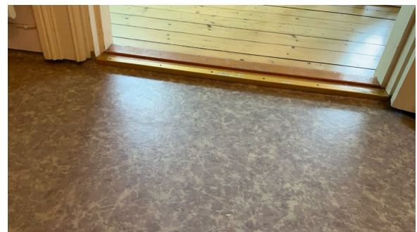
Ingen oppkant mot terskel
