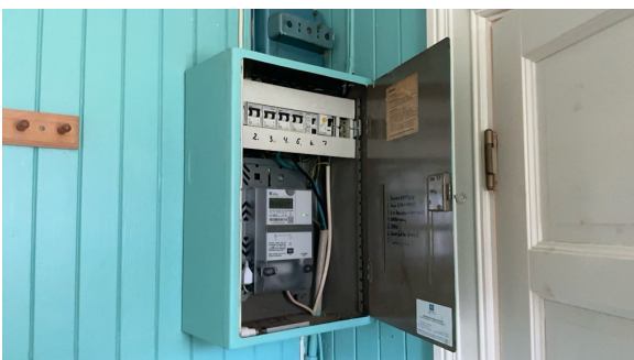
Sikringsskap med automatsikringer i gang 2. Etg
