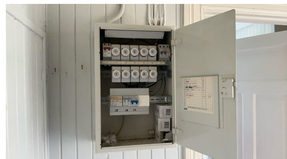
Sikringsskap med skrusikringer i gang 1. Etg.
