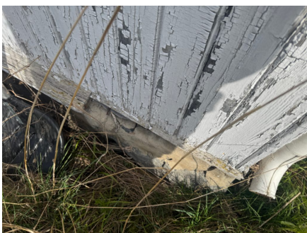
Dels manglende vannbrett
