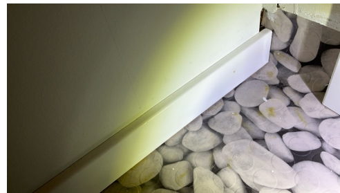
Gulvlister i våtsone er feil. Belegg burde vært brettet opp.
