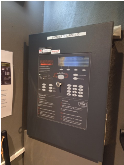
5306000 - Kontroller at brannsentral registrerer "Nøkkelsbryter utkob..."
