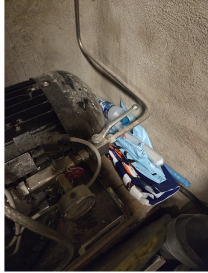
5306007 - Åpne isolasjonsventilen ut til de beskyttede rommene.
