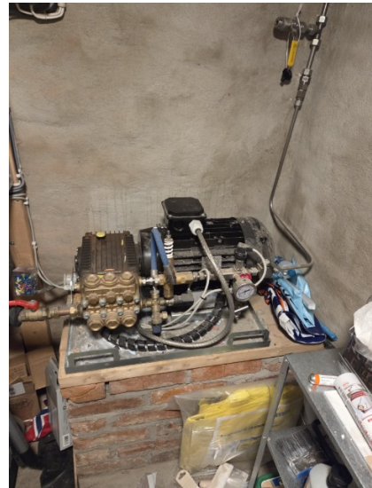
5305998 - Kontrollere at det ikke er lekkasje fra pumpe
