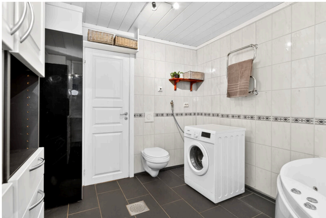
Vegghengt toalett og opplegg for vaskemaskin.
