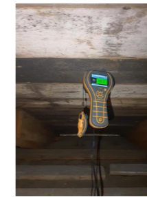
Synlige overflater (taktrø, vegger, gulv, o.l.) - Fuktmåling i området med misfarging/mørkere området.
