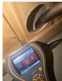
Kontroll i lukkede konstruksjoner - Fuktmåling i utlekket vegg mot terreng.
