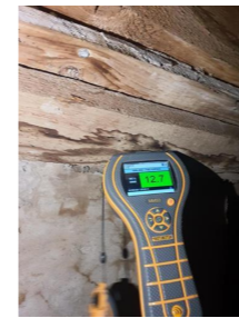
Synlige overflater (taktrø, vegger, gulv, o.l.) - Fuktmåling på fuktmerke i konstruksjon ved pipe.
