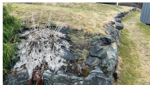
Uten rekkverk, det meste er < 0,5m og mykt å lande.
