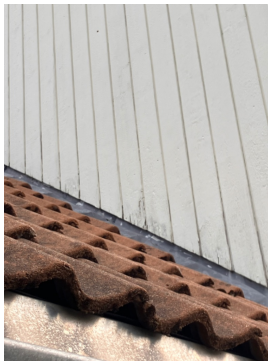
Antydning til råte i kledningsbord på vegg over garasjetak
