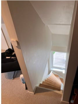
Trapp til loft mangler rekkverk og håndreke
