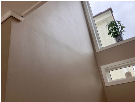
Ujevn flate på vegg i trapp
