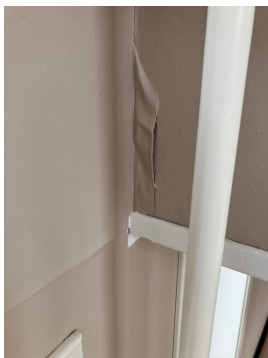
Sparkelbånd har løsnet som følge av håndverksfeil
