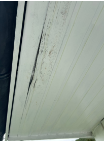
Noe råte i kledning under takutstikk
