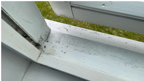
Fukt/råteskade badvindu gavl øst
