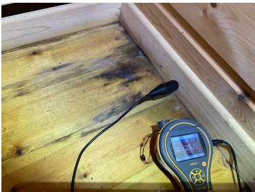
Fuktskada trevirke badstue
