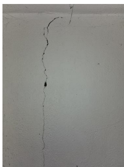
Grunnmur og fundament - Riss/sprekker grunnmur.
