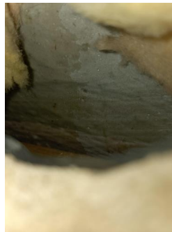
Kontroll i lukkede konstruksjoner - Fuktmerker utlektet kjellevegg.
