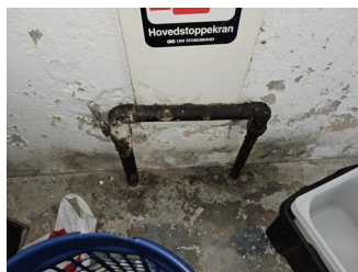
Innvendig stoppekran - Felles hovedstoppekran.
