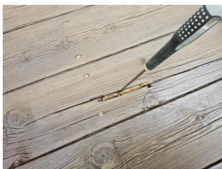
Tilstand på rekkverk og overflatematerialer - Råteskader terrassebord.
