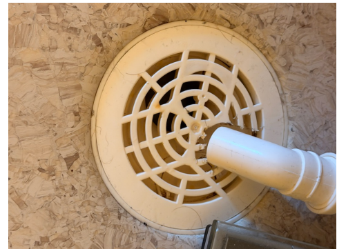
Tilleggs sluk under baderomsinnredningen.
