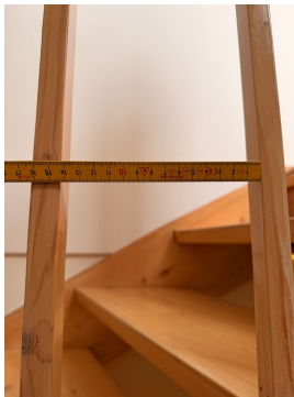
For store åpninger i rekkverket.
