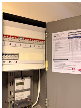
Sikringskap med automatsikringer.
