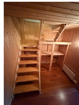
Trapp til kjeller mangler rekkverk og håndløper.
