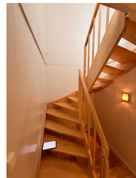
Mangler håndløper i trappeløpet.
