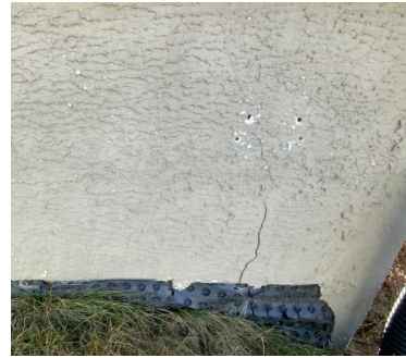
Utvendig sprekkdannelse ved monteringshull.
