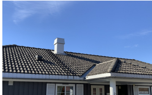
Ikke påvist avvik for hovedtekking. Det presiseres at hovedtekking kun er besiktiget fra bakkenivå.
