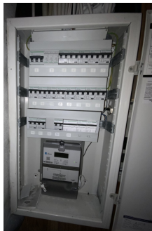
Sikringskap med automater, på bod i kjeller.
