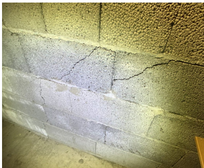
Noe større sprekkdannelse i grunnmur under garasje ble påvist ved befaring 20.05.2026.
