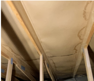
Undertak med fuktskjolder.
