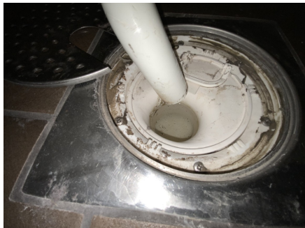
Sluk under dusjkabinett
