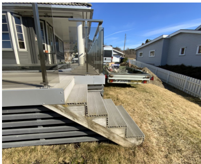
Trapp til terrasse mangler rekkverk.
