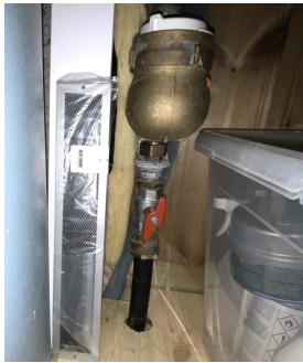
Stoppekran på teknisk rom i kjeller.
