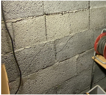
Skrårikk sett i leca under garasje (01.04.2025).
