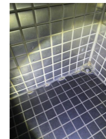
Overflater gulv - Løs flis i hjørne i dusj.
