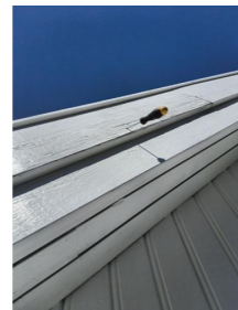
Vannbord, vindskier, gesimskasser og lignende - Råteskader påvist på vindskier.
