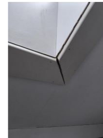
Takvinduer - Merker etter fukt på foring, list og tak til takvindu.
