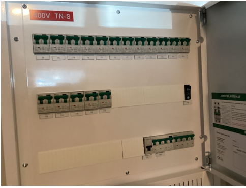
Bilde av sikringskap
