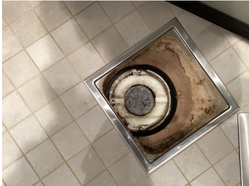
Bilde av sluk.
