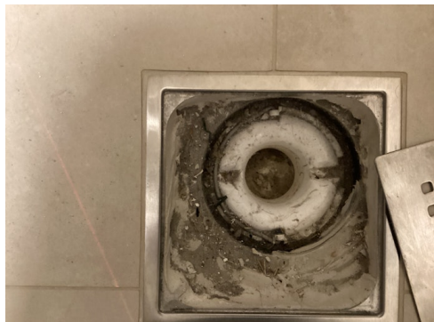
Bilde av sluk.
