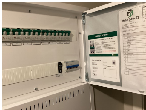
Bilde av sikringskap.
