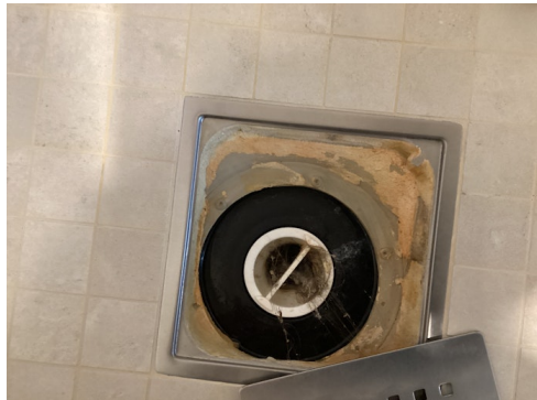
Bilde av sluk
