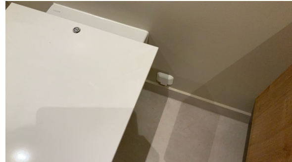
Dren fra rørskap
