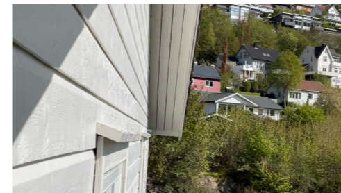
Værslitt vannbord over vindu
