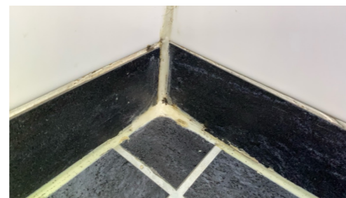
Stedvis misfarga fuger
