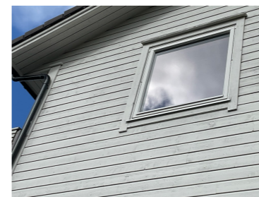
Værslitasje gavl sørøst
