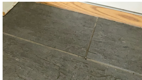
Oppsprekt fuge, bomlyd i flis
