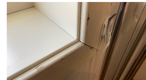
Vindu våtzone, avflassa listverk
