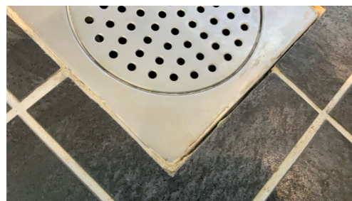
Løstna fuge ved slukramme
