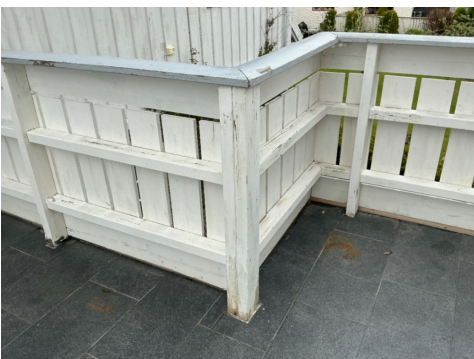
Avflassing av maling, ikke synlig oppkant/tettesjikt rundt stolper. Ytterligere undersøkelser og dokumentasjon anbefales å utføres.
