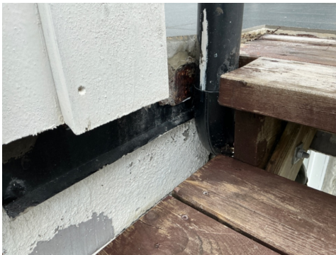
Noe rust, manglende tildekning mm
