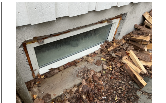
Synlig byggsaum, må tildekkes, brannfarlig
