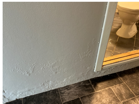
Saltutslag på vegger
