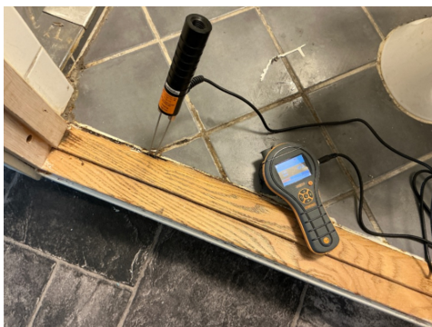
Målt fukt og råteskader ved terskel
