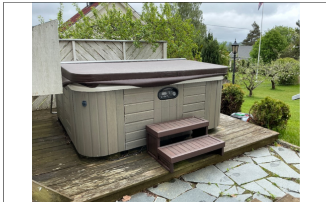
Boblebad, værslitte terrassebord TG2, råteskader i rekkverk/levegg TG3
