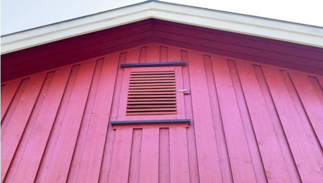
Luftesjalusi i inspeksjonsluke i gavlspiss.
