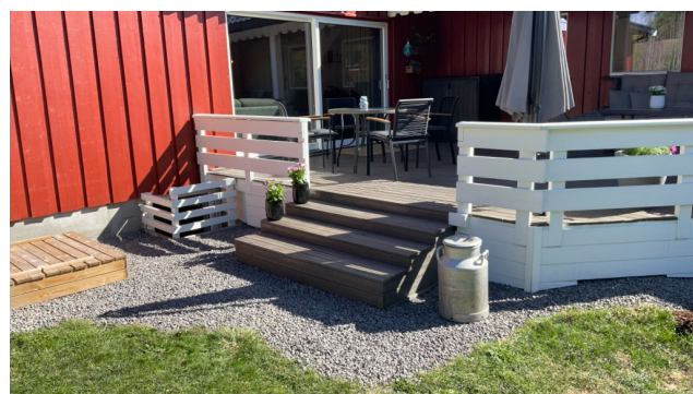
Trapp til veranda uten rekkverk
