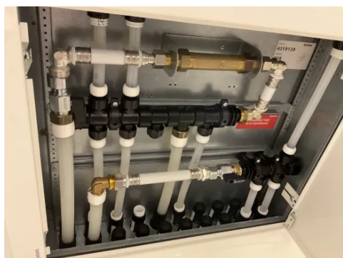
Fordelerskap plassert i himling på baderommet
