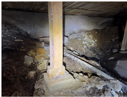
Fuktskjolder i grunnmur og noe fuktig grunn i krypkjeller
