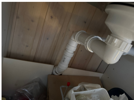
Avløpsrør under vask på kjøkken
