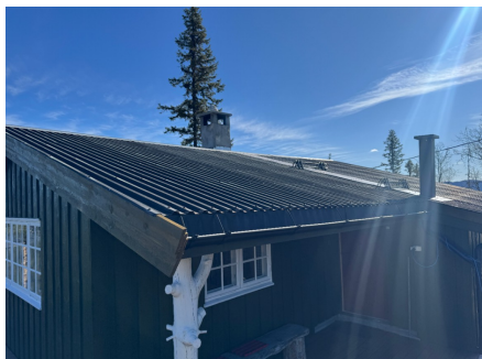
Ikke montert snøfangere på tak
