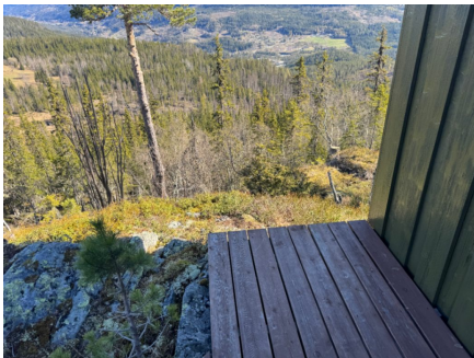
Ikke montert rekkverk på platting
