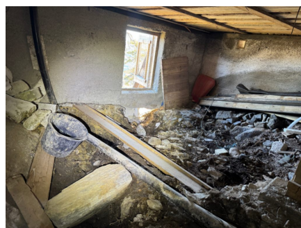
Jordmasser som har glidd ut under grunnmur på undersiden av luke til krypkjeller
