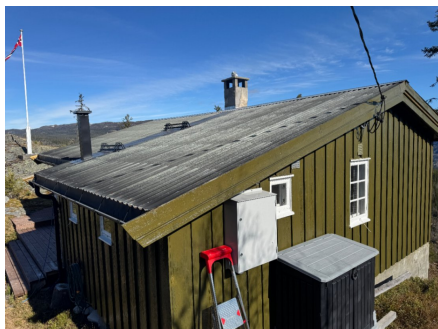
Overflateslitasje i taktekking
