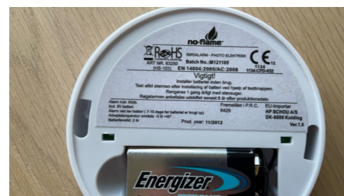
Brannvarsler fra 2012, og er > 10 år, MÅ skiftes.
