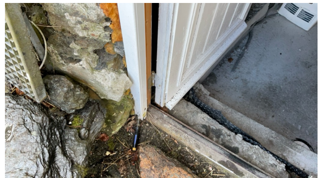
Råteskader på karm.
