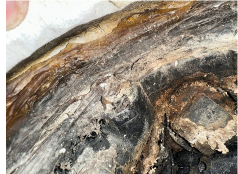
Eldre vinylbelegg er synlig mot sluk.
