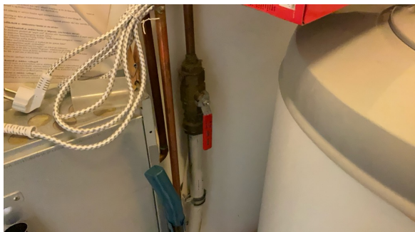
Innvendig hovedstoppekran er plassert i bod.
