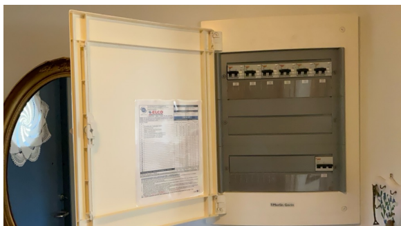
El-anlegg med automatsikringer. I hovedsak skjult ledningsnett. Sikringsskapet er plassert i entrè.
