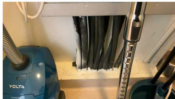
Samleskap for rør-i-rør opplegget har ikke tilfredsstillende lekkasjekontroll. Ved en eventuell lekkasje vil vann kunne renne til områder som ikke har et vann tett sjikt. Det vil si at det kan oppstå fuktskader i områder rundt fordelerskapet.
