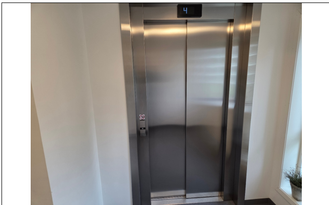
Heis med adkomst etasjene.
