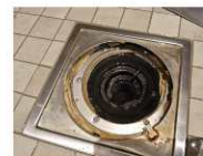
Tettesjiktets tilslutning til sluk - Sluk i bad 1. etg.
